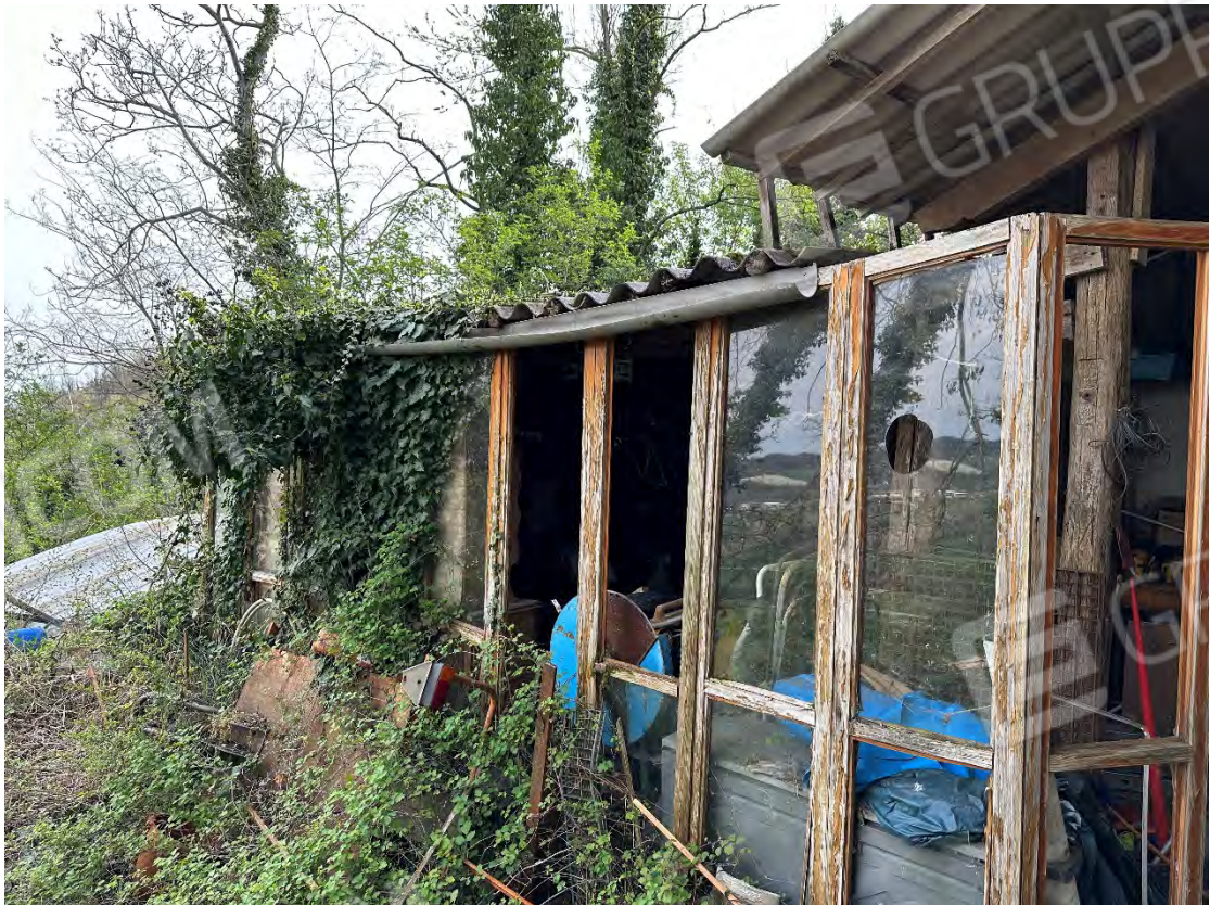
TETTOIA ABUSIVA DA RIMUOVERE
