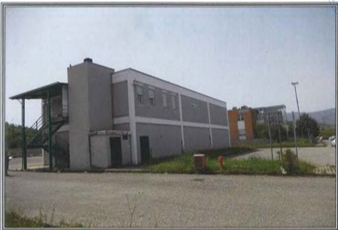
FOTOGRAFIA n. 2: Vista Esterna Area Manutenzione e Pulizie (MP)
