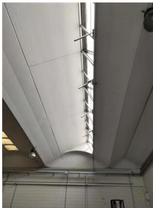
Particolare luci copertura capannone
